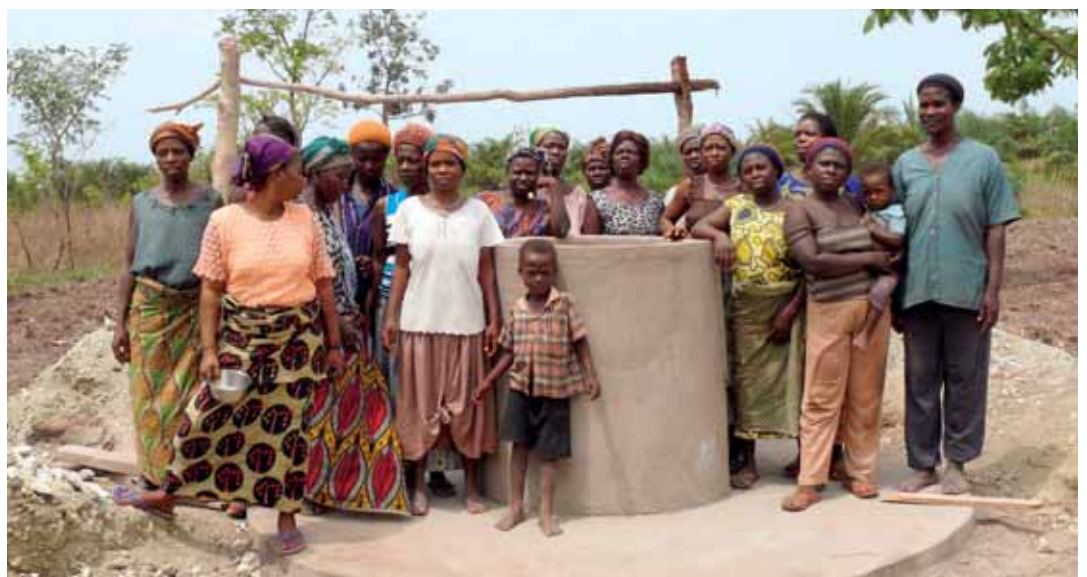
Durch den Bau von vier Brunnen kann das Gemüse in Tado bewässert werden.
