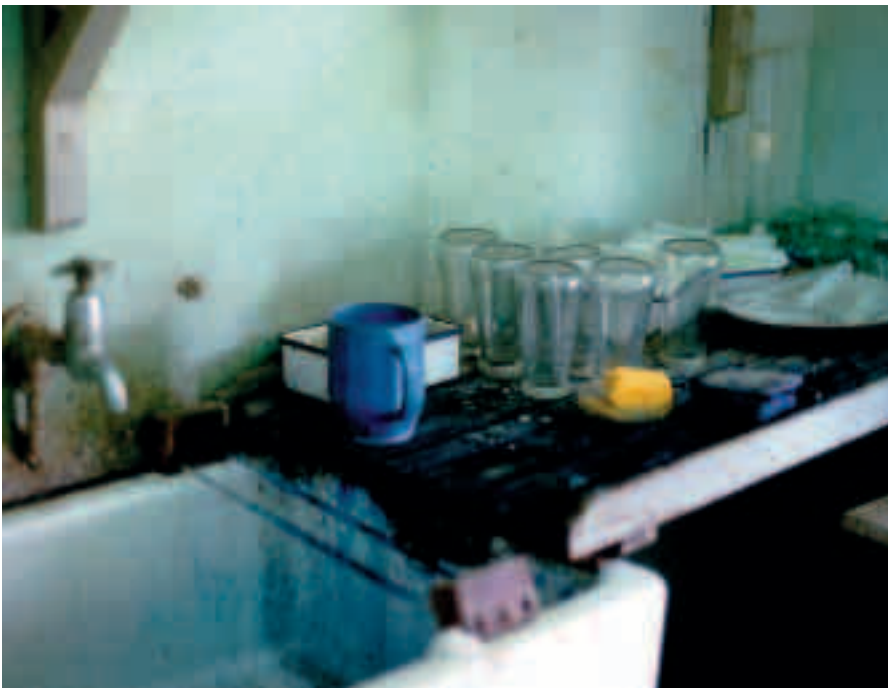
Die über 50 Jahre alte geburtshilfliche Abteilung muss dringend renoviert werden.
